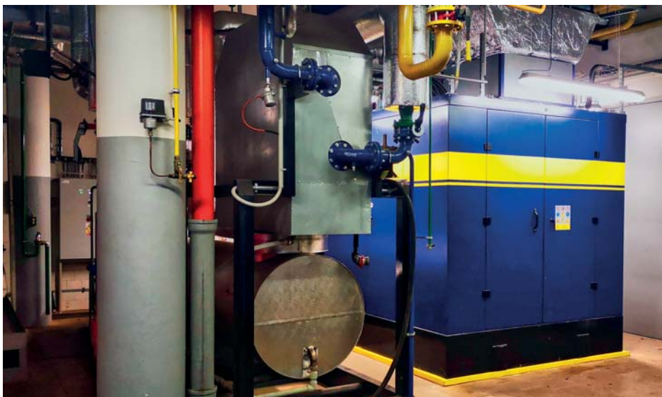
Město Broumov letos zmodernizuje dvě plynové kotelny, které doplní o kogenerační jednotky a fotovoltaické články.
